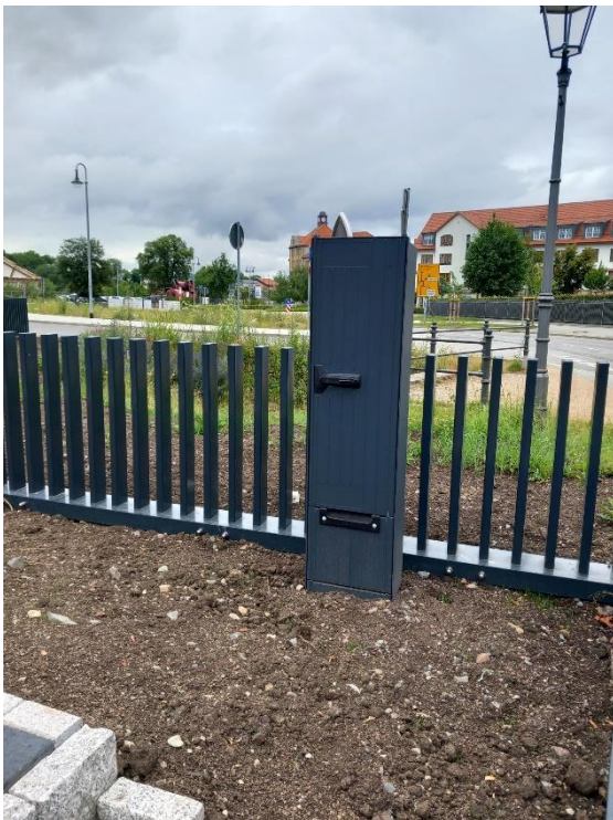
Abbildung 4 Stromanschlüsse an der Gastronomiefläche
